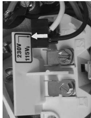
Figure 4A - Prise de changement de tension réglée pour le courant de 230 volts
